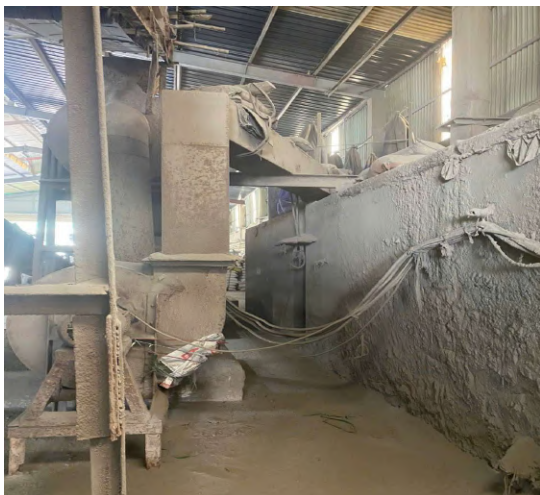
Hình ảnh đường ống và bể đập bụi
