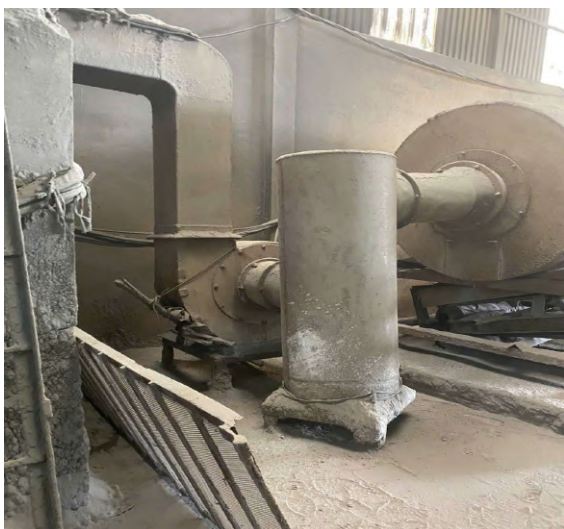
Hình ảnh cyclone và đường ống
