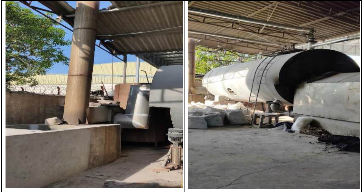
Hình 3.2. Lò hơi và hệ thống bể xử lý khí thải lò hơi
