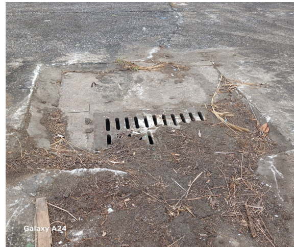
Hố ga thu gom nước mưa
