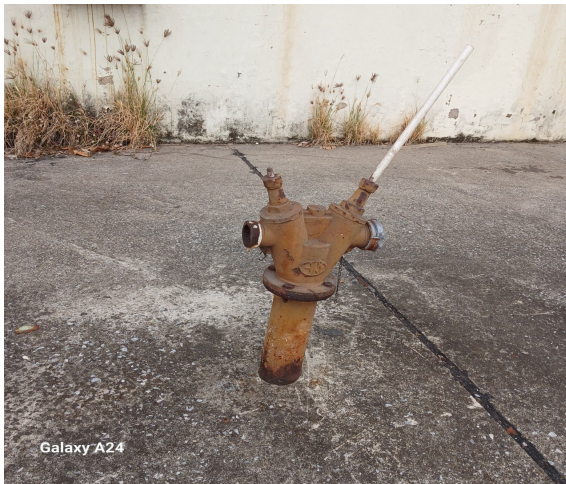
Hạng cấp nước chữa cháy
