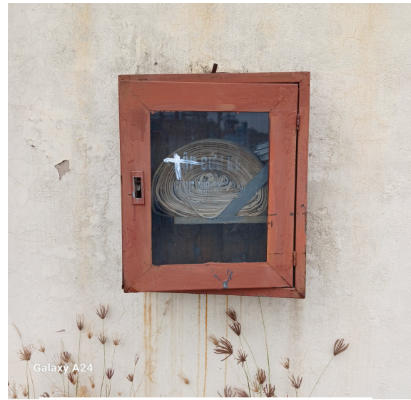
Hộp dây chữa cháy
