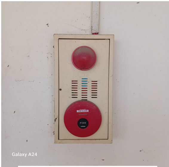
Thiết bị báo cháy
