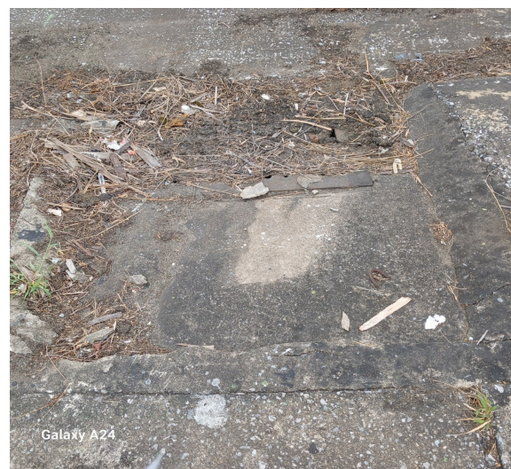
Hố ga thu gom nước thải
